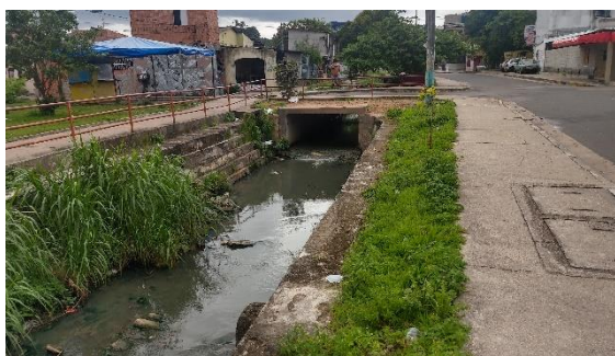
Foto: O igarapé da Sapolândia após as ações do PROSAMIM. Nota-se o total assoreamento e contaminação das águas.
